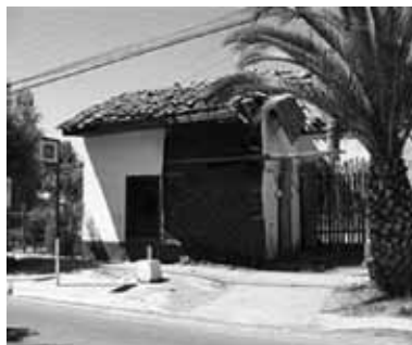
Daño terremoto febrero 2010
