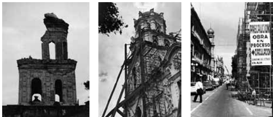
Figura 3. Daños en la torre del Templo de San Agustín y apuntalamiento de obras Foto archivo personal A. Enrique Benítez Barranco
