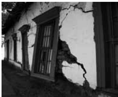
Daño terremoto febrero 2010
